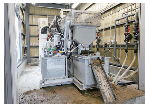
水質浄化・廃水処理設備
